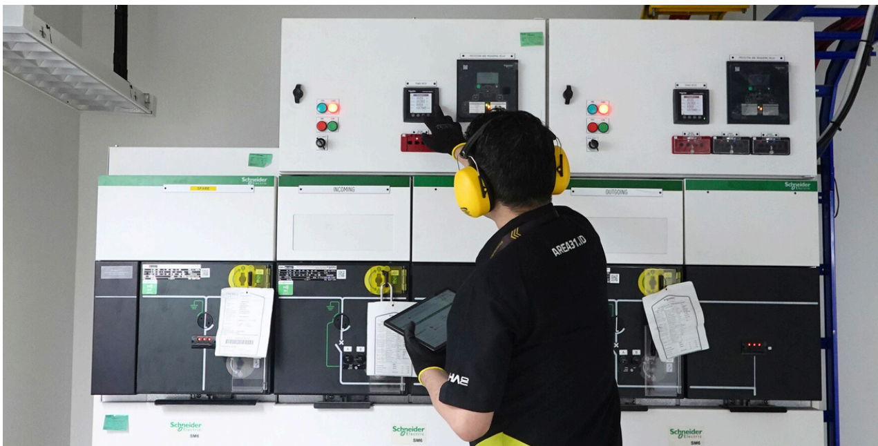
Pemeriksaan rutin pada ruangan Trafo Routine checks on the transformer room
